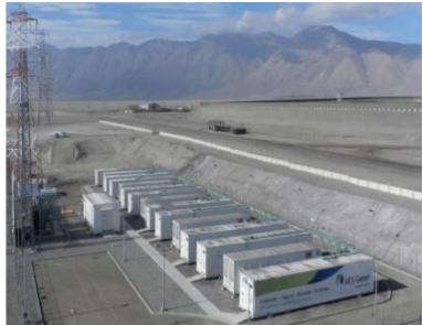
Sitio del Sistema de almacenamiento de energía de AES Gener
